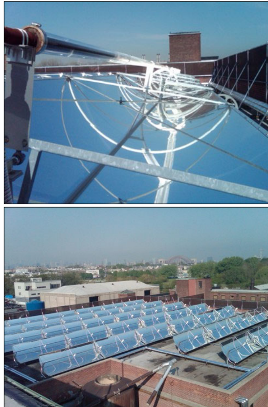
Figure 2: Abengoa IST Parabolic Solar Collectors
